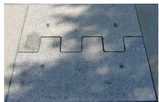
Foto 6 Die beiden Platten in eingebautem Zustand mit Verschlussstopfen
